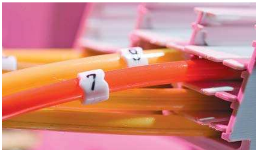
FOTO: DEUTSCHE TELEKOM AG
